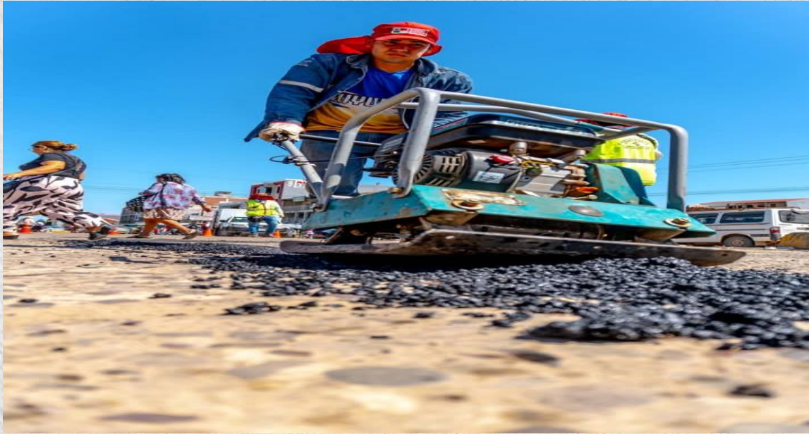
Bacheo en Avenida Circunvalación Este
